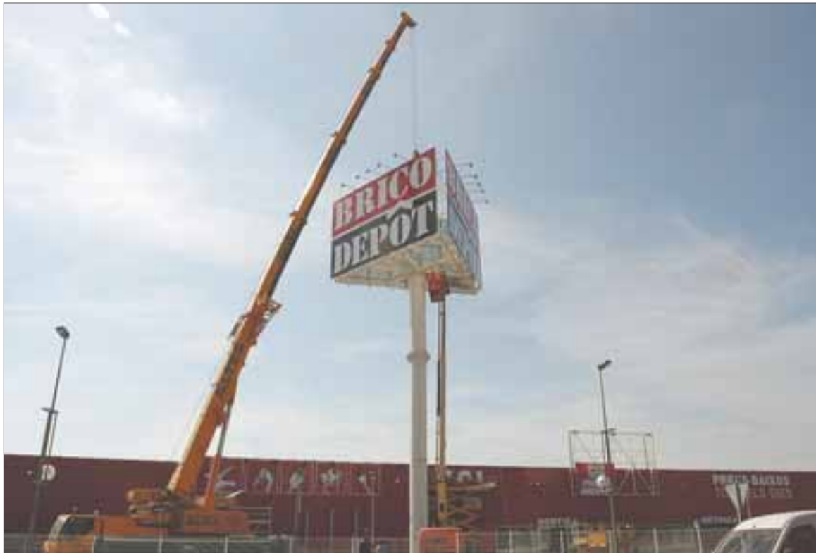
Imagen de las últimas obras que se están realizando en el nuevo establecimiento. FOTO: LLUÍS MILIÁN
